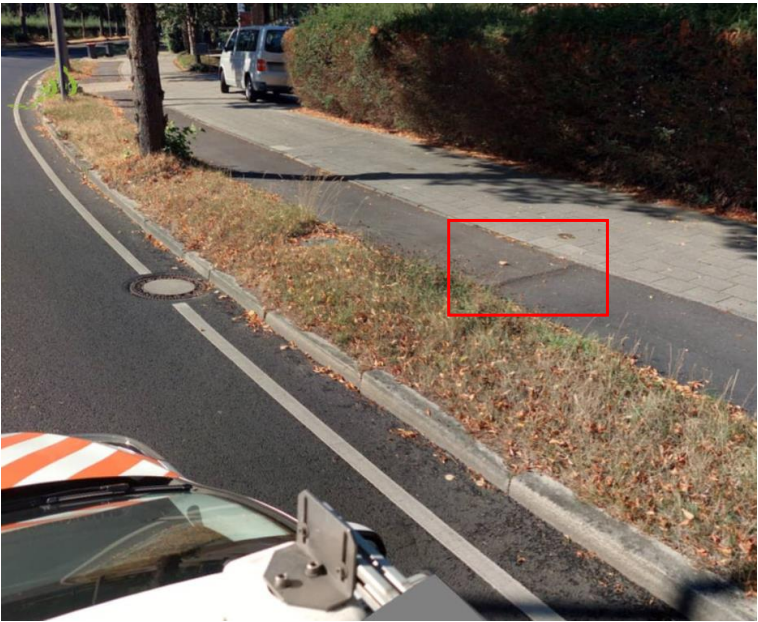
Optische Schadenserfassung durch Bildbefahrung
