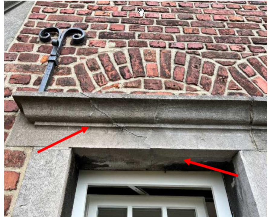
Schäden durch Überlastung
