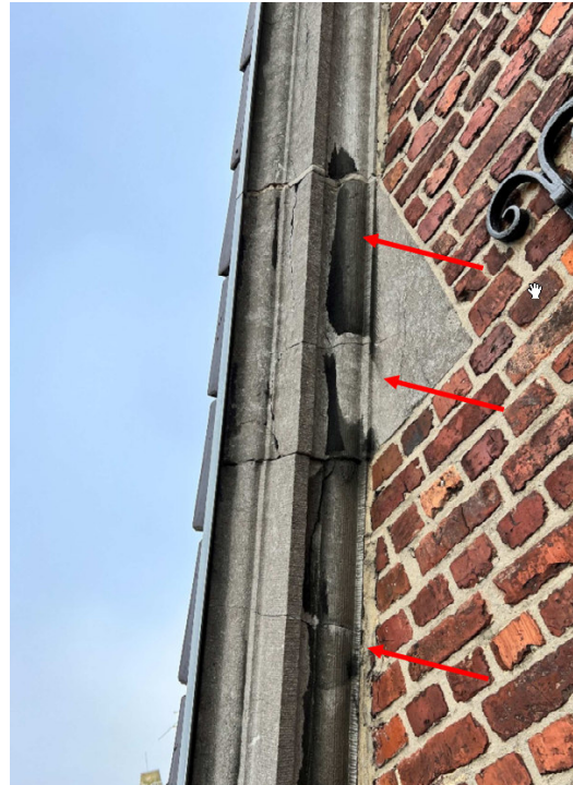
Untypisch stark geschädigte Gesimssteine
