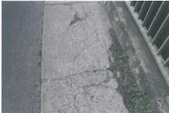
Abbildung 1: Risse im Gehweg
