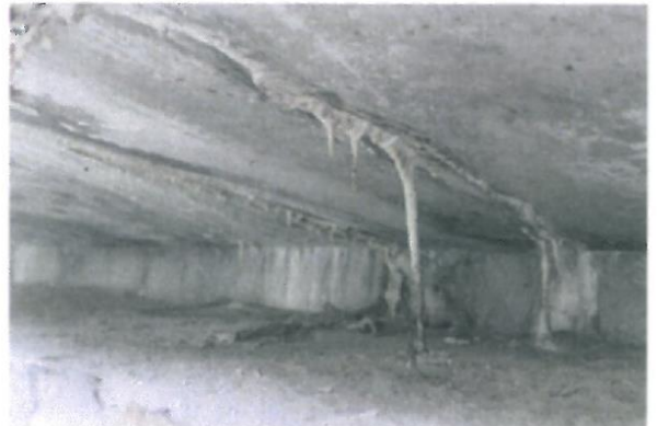
Abbildung 4: Durchfeuchtung der Kappenkonstruktion
