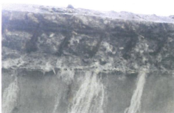
Abbildung 3: Freiliegende Bewehrung (Unterseite)
