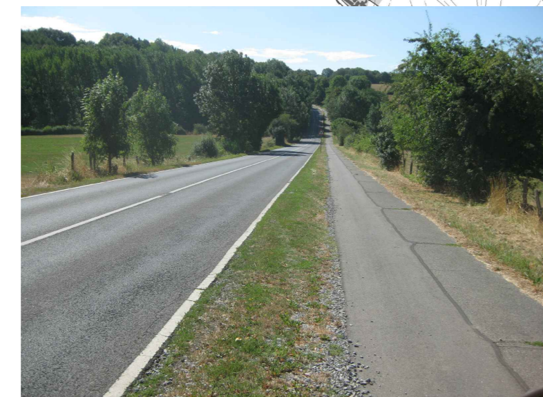
Bild I: Starke Neigungen Aachener Straße
