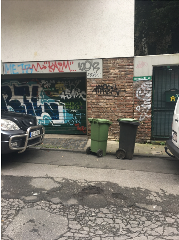
Abb.3: Mitte Richardstraße; Fahrbahndecke vor Einfahrten
