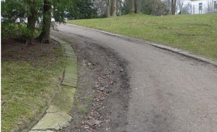
Schäden der wassergebundene Wege im Stadtpark
