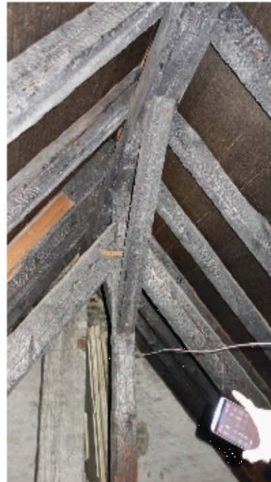
Spitzboden/Speicher mit Brandschaden Tragwerk
