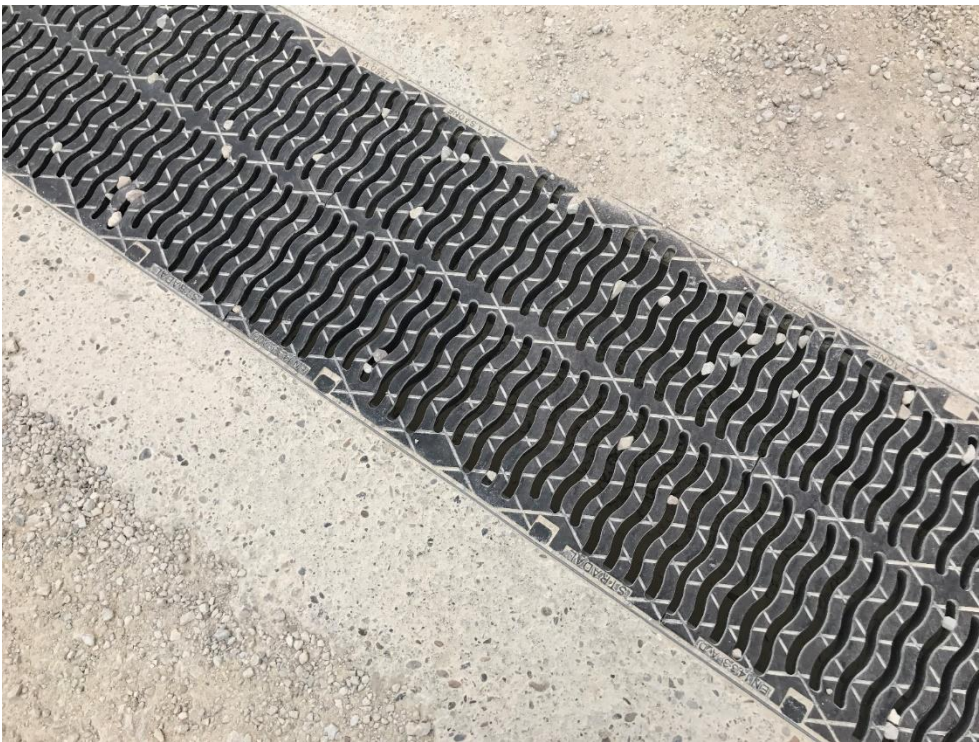
Abbildung 13: Gerinneabdeckung aus Gusseisen in Saint-Rémy-de-Provence
