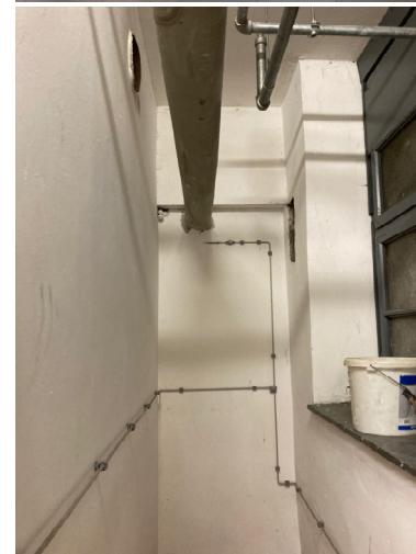
Technikraum (SPZ) unterhalb Aufstellort
