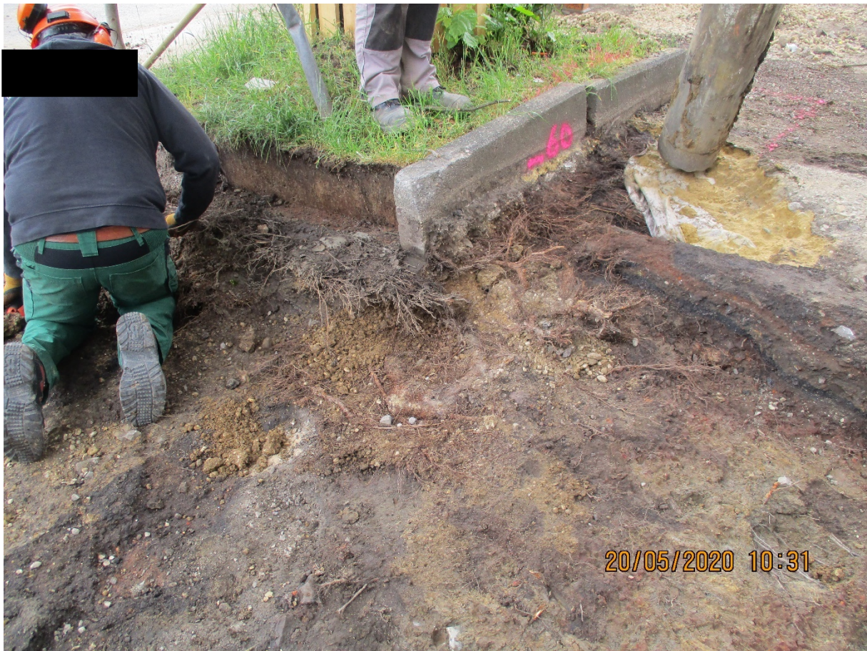
Abbildung 4: Das in Handarbeit freigelegte Wurzelwerk wird für die weitere Baumaßnahmen geschützt; der Baum profitiert und kann sich in Zukunft deutlich besser entwickeln.
