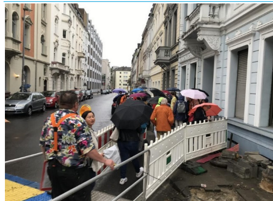
Abbildung 10: Nicht barrierefreie Baustelle an der Lochnerstraße
