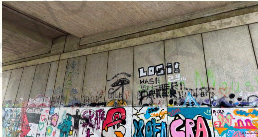
Abb. 233: Aktueller Zustand der Wände an der Autobahnunterführung
