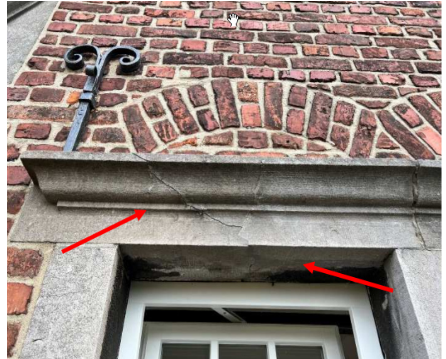
Schäden durch Überlastung
