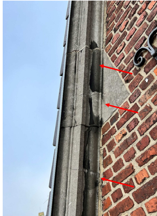
Untypisch stark geschädigte Gesimssteine
