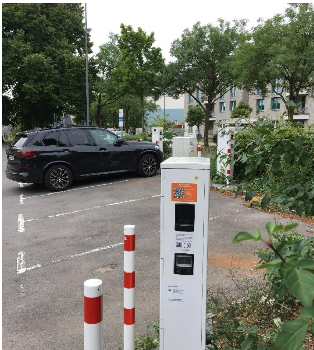
Abbildung 19: Ladeinfrastruktur an der RWTH
