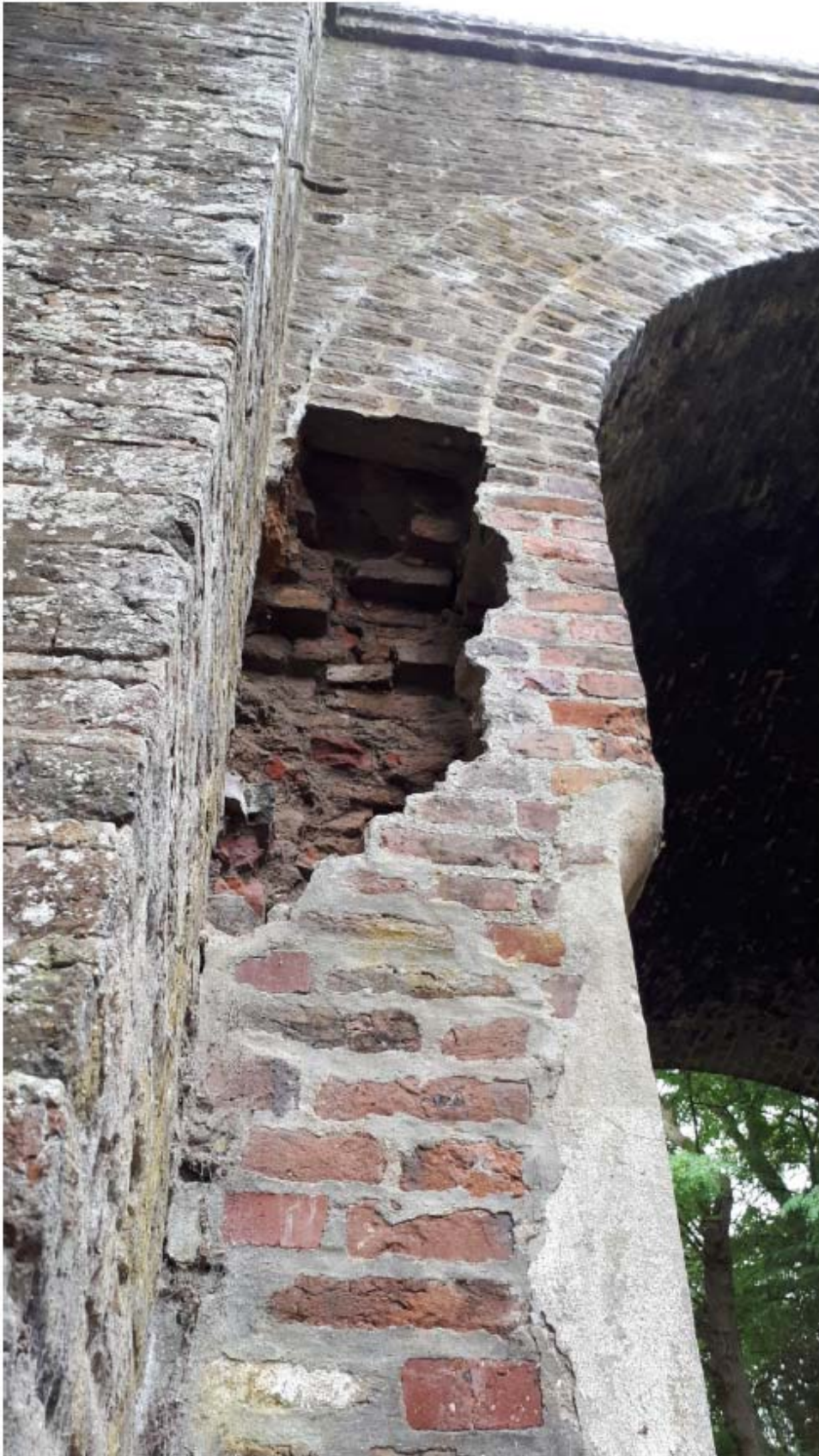
Aktuell neuer Schaden
