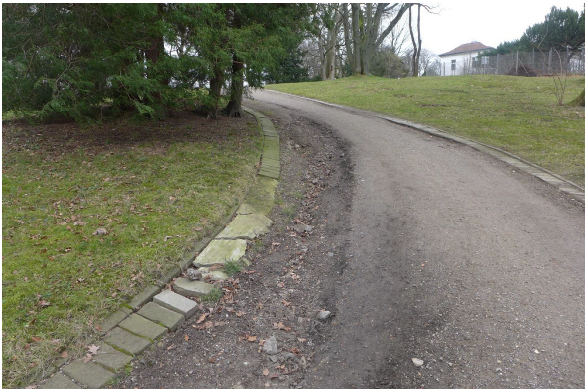
Abb. 7: Beispiel für schadhafte wassergebundene Decke, Einfassung und Entwässerung außer Funktion
