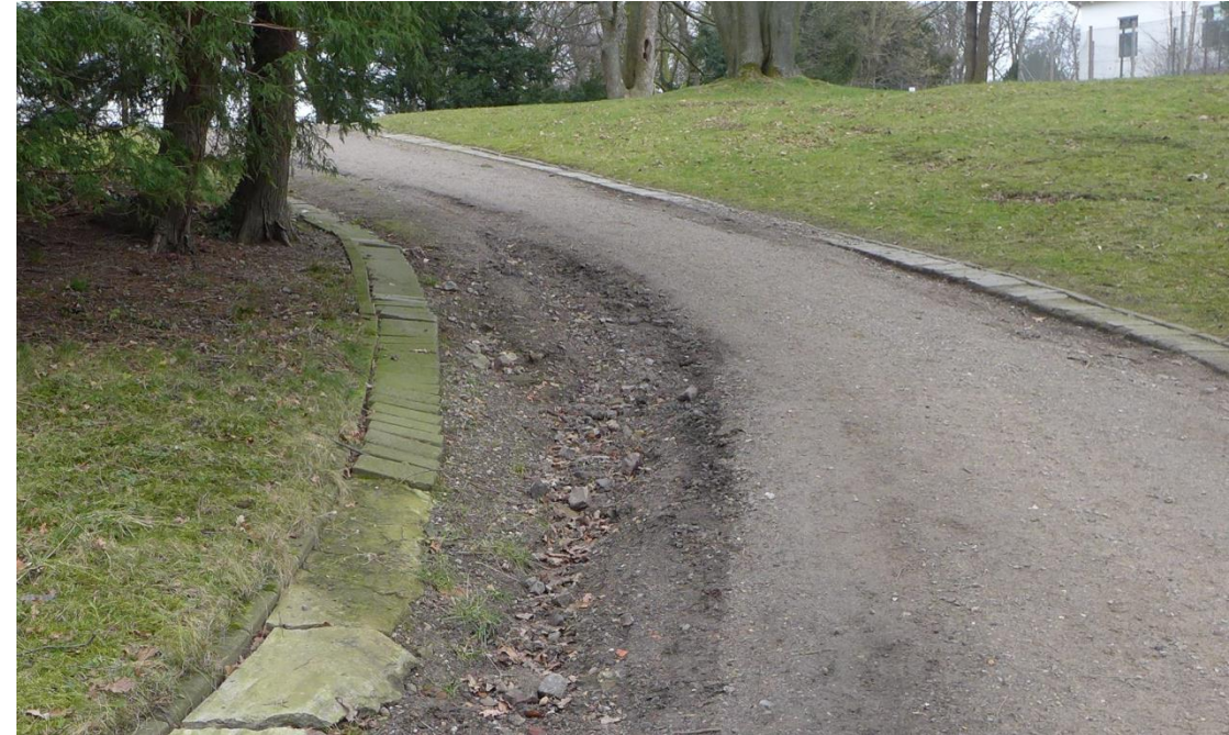
Schäden der wassergebundene Wege im Stadtpark
