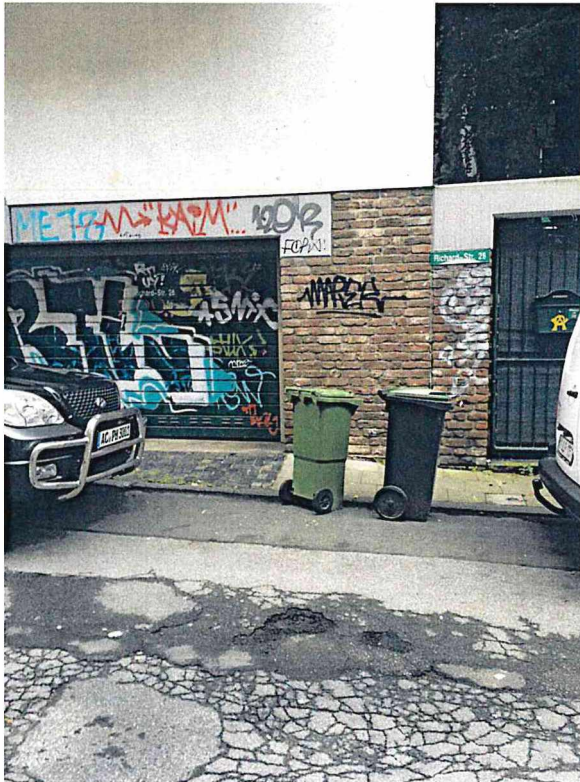
Abb.3: Mitte Richardstraße; Fahrbahndecke vor Einfahrten
