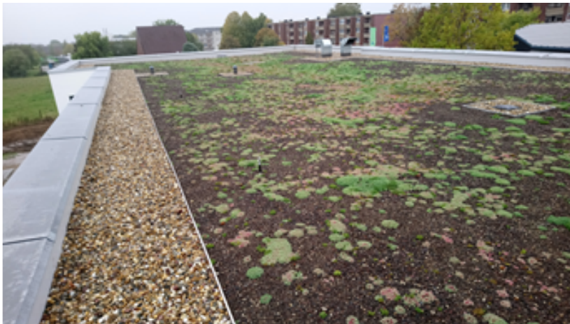
extensive Dachbegrünung Kita Sittarder Str.
