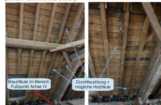
Abb. 26 - 27: Durchfeuchtung der Sparren und Dachschalung (Achsen III-IV / A-C) mit möglicher Holzfäule insbesondere auf der Außenseite zwischen Bitumenbahnen und Dachschalung, Fußpunkt Achse IV lt. Starmanns mit Braunfäule (Bild 27 Ausschnitt aus Bild 26).
