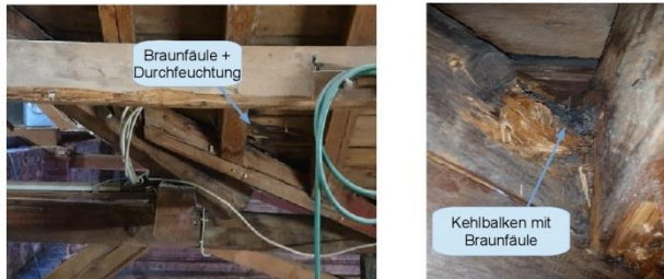
Abb. 17 - 18: Braunfäule (Kehlbalken) und Durchfeuchtung der Dachschalung (Achsen III-IV / E-G) im Bereich des Treppenaufgangs.
