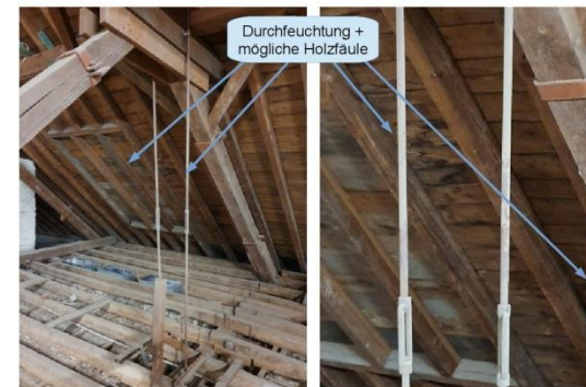
Abb. 24 - 25: Durchfeuchtung der Sparren und Dachschalung (Achsen II-III / A-B) mit möglicher Holzfäule insbesondere auf der Außenseite zwischen Bitumenbahnen und Dachschalung (Bild 25 Ausschnitt aus Bild 24).
