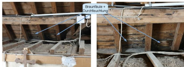
Abb. 19 - 20: Durchfeuchtung mit Braun- und Moderfäule sowohl der Pfette als auch der Dachschalung (Achsen II-III / E-G) im Bereich des Treppenaufgangs. Die Pfette hängt aufgrund der Holzfäuleschäden deutlich durch. Sie ist mitsamt Schalung und vermutlich auch den Sparren in dem Bereich auszutauschen.
