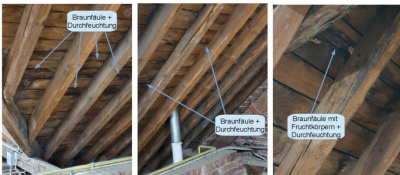
Abb. 21 - 23: Braunfäule teilweise bereits mit Fruchtkörpern ( Antrodia sp. Braunfäuletrameete synonym Weißer Porenschwamm) und Durchfeuchtung der Dachschalung (Achsen II-III / D-E) im Bereich neben dem Treppenaufgang.
