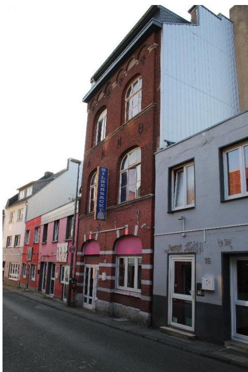
Abbildung 15: Antoniusstraße 18 (Mitte): Einzeldenkmal mit erkennbaren Baumängeln im Sockelbereich, an der Fassade und den Fenstern ab dem Erdgeschoss Quelle: Eigene Aufnahme
