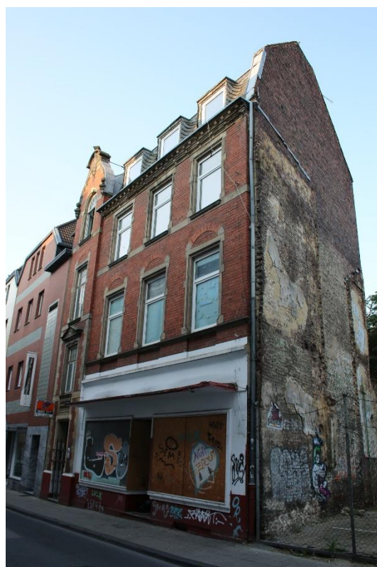
Abbildung 11: Mefferdatisstraße 22: Gesperrtes Gebäude mit erheblichen Baumängeln Quelle: Eigene Aufnahme
