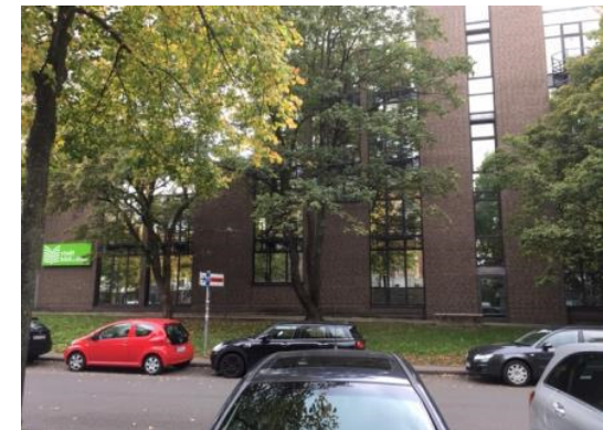
Eingangsbereich umgebaut 2021 Verspiegelte Fenster sollen gegen Klarsichtfenster ausgetauscht werden. Transparenz stärkt Sicherheitsgefühl.
