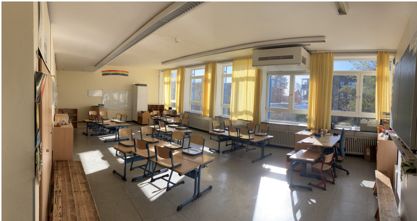
KGS Oberforstbacher Straße Klassenraum Deckengerät LTM Dezent 800 topline eco
