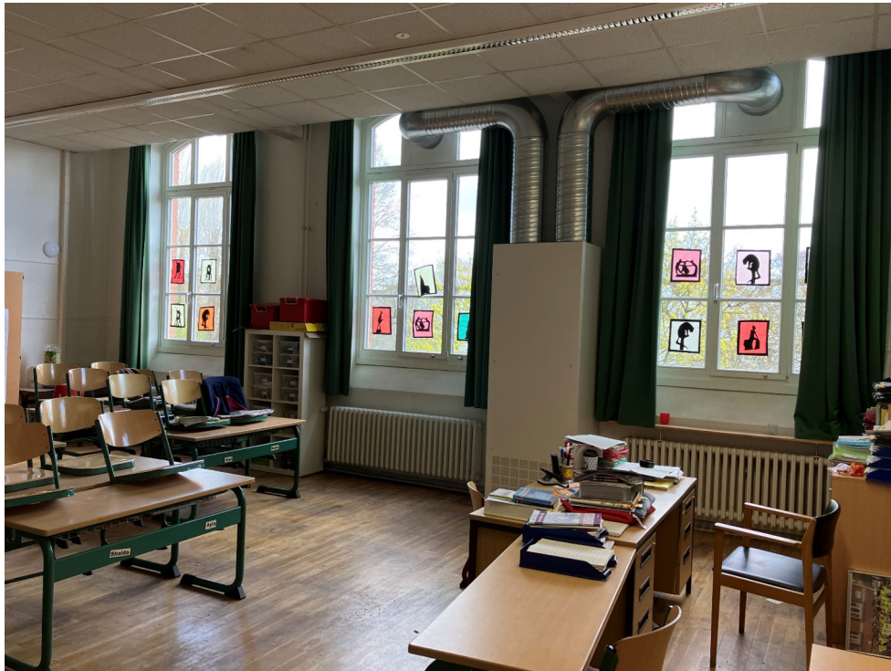
KGS Düppelstraße Klassenraum Standgerät Airflow Duplex Vent 900
