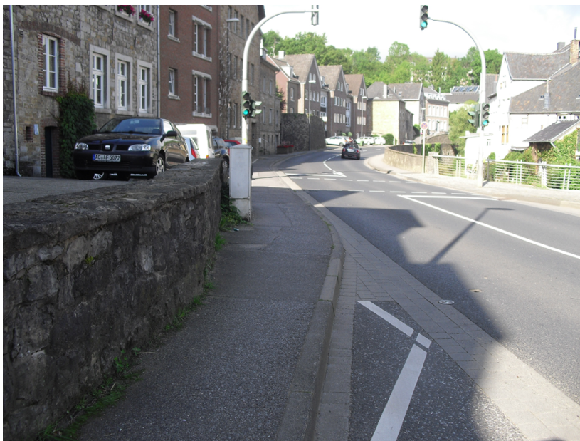
Abbildung 1: Bruchsteinmauer vor den Häusern 190/192
