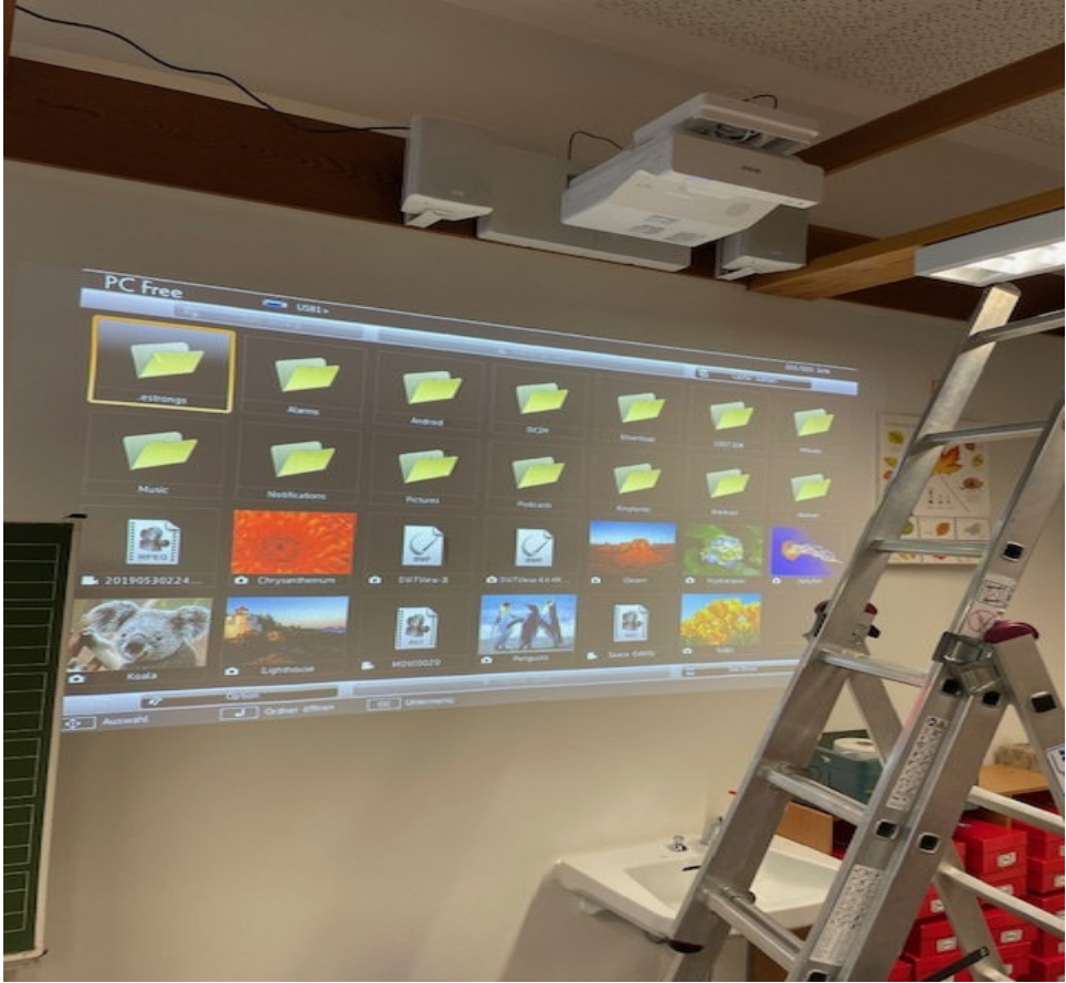
Beispielbilder für einen Ultrakurzdistanzbeamer der Marke Epson mit einem Lautsprechersystem.
